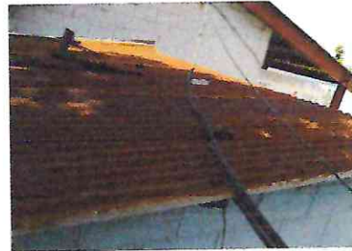
Foto 6: Techo y estructura en mal estado
