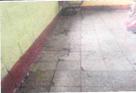
Foto 3: Piso dañada en un aula
