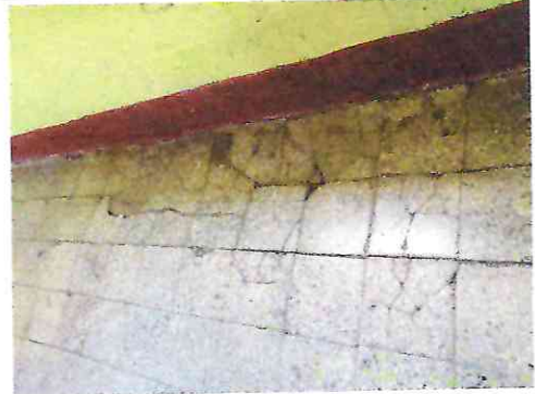
Foto 2: Piso de granito en mal estado
