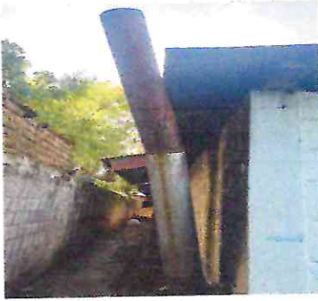
Foto 1: Chimenea en mal estado
