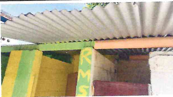
Foto 5: estructura deficienteen los baños
